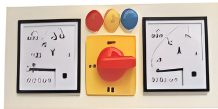
SQUARE (METERING PANEL)
